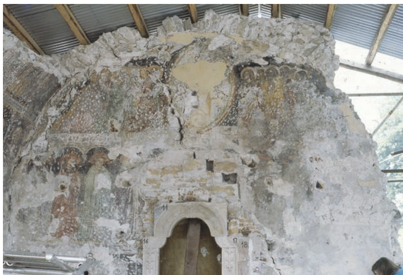
Fig. 2 - Ospedaletto di Gemona (Gemona del Friuli - UD), Chiesa di Ognissanti dopo il terremoto che colpì il Friuli nel 1976.
