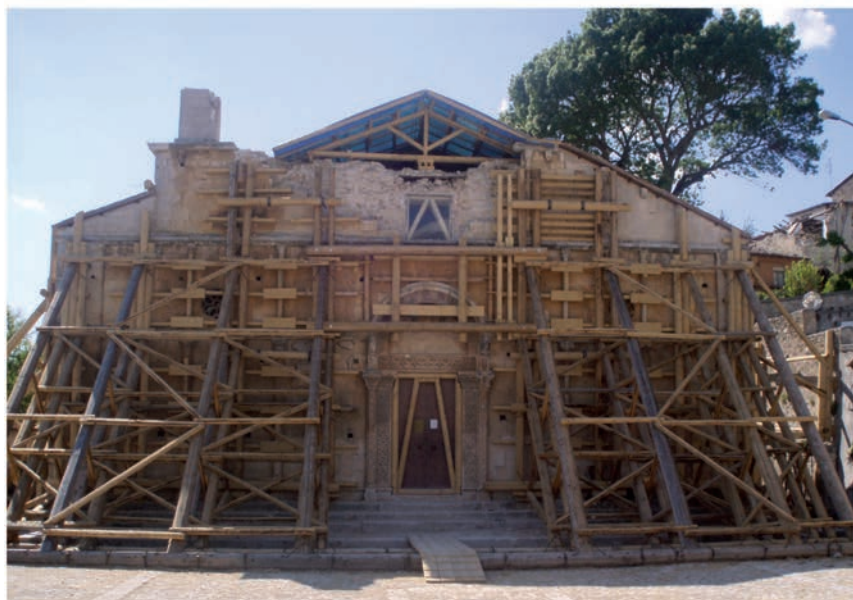
Fig. 14 – Quadro fessurativo e puntellamento della facciata di S. Giusta a Bazzano (L'Aquila).
